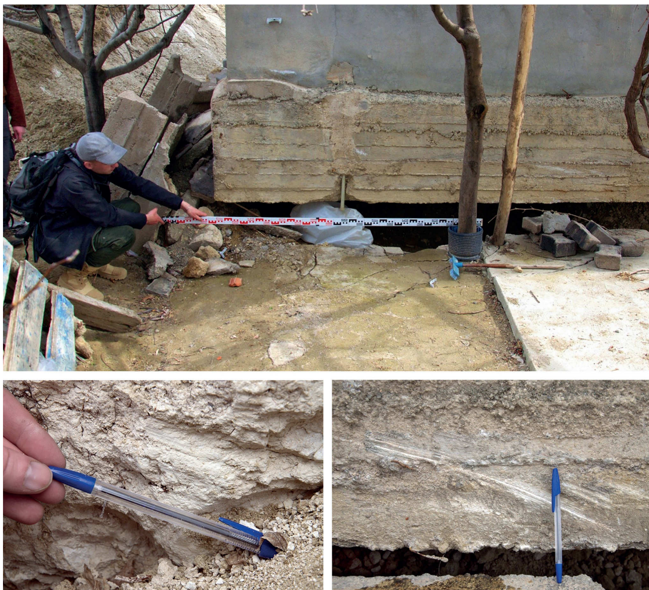
Рис. 9. Левосдвиговое смещение на 1.71 м и поднятие юго-восточного крыла на 0.55 м стены дома над сейсмогенным разрывом 06.02.2023 г. Дом поднят и смещен влево относительно облицовки грунта возле дома. Косая штриховка на известняке рядом с домом (слайд 1, слева) и на бетоне фундамента (слайд 2, справа) указывает на преобладание левого сдвига над вертикальным смещением.
