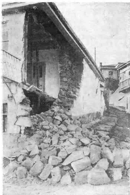
Рис. 2. Стена дома в Дерское близ Ялты. На оставшейся части стены видно ее расслоение вследствие дурной связи кладки.
