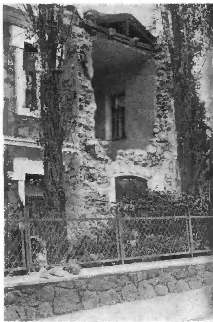
Рис. 5. Выпавшая стена дома быв. Гудима в Ялте. Плохое сопряжение углов выступающей пристройки. Выпадению способствовал толчек стропил вверх.
